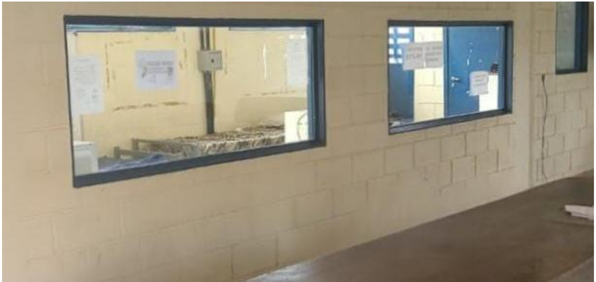
Figura 16 - Separação entre pátio e monitoria com acrílico -UISS
