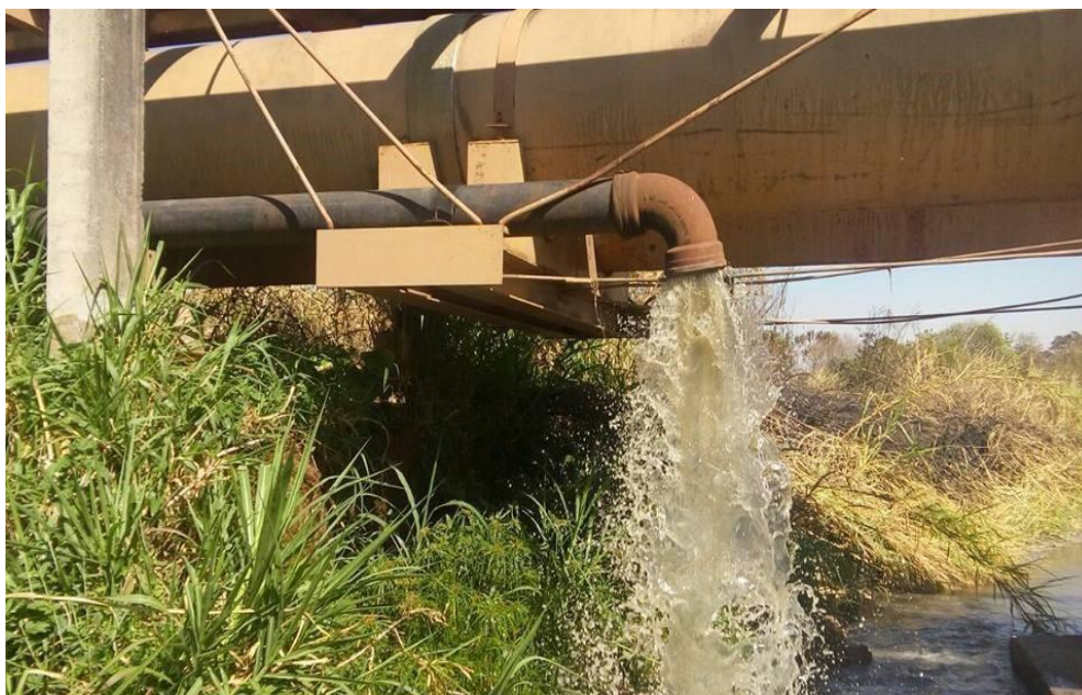
Figura 12 - Imagem da Tubulação CAESB no Rio Melchior.
