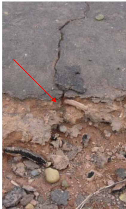
Figura 1.1 – Trinca localizada no revestimento e base.
