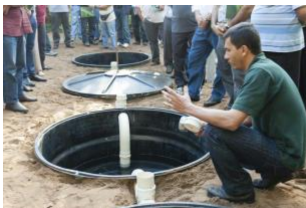
FIGURA 9: FOSSA SÉPTICA BIODIGESTOR E CLORADOR EMBRAPA
