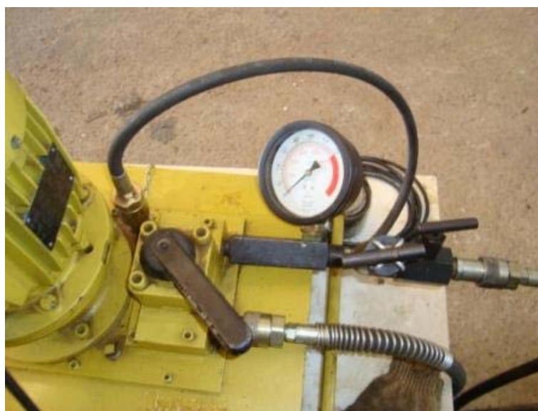
Figura 3.43 – Sistema de válvulas de ajuste fino.
