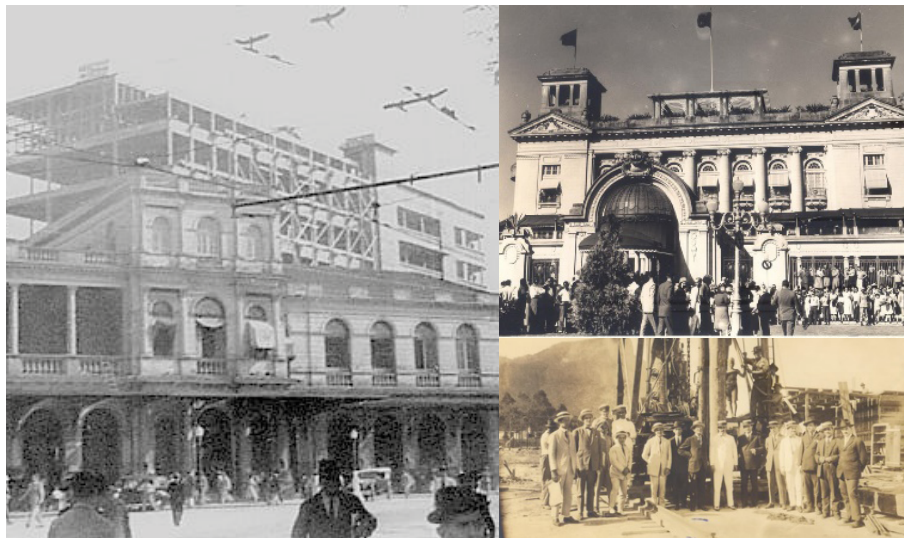
Figura 20a, 20b e 20c – Obra do Hipódromo da Gávea, Rio de Janeiro, 1926. Utilizou elementos pré-moldados nas fundações e nos cercamentos
