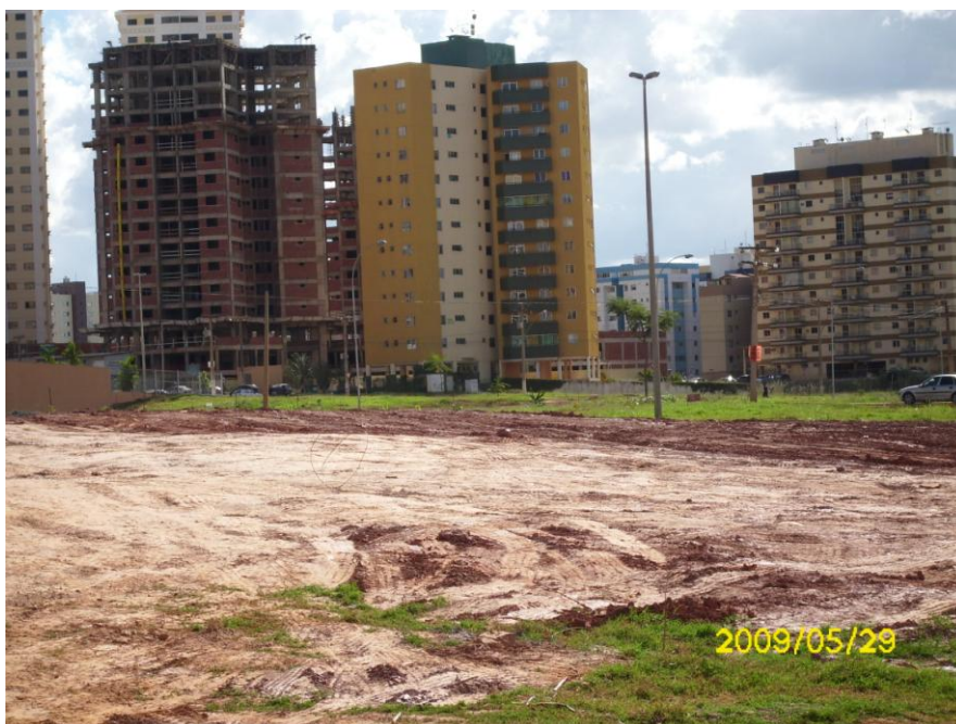
Foto 15: Utilização de Área Pública pela EMP A e que serve para movimentação de caminhões, escoamento de resíduos e coleta dos entulhos colocados nas caçambas fixadas no local. Ao fundo, vê-se mais um edifício em construção em Águas Claras.
