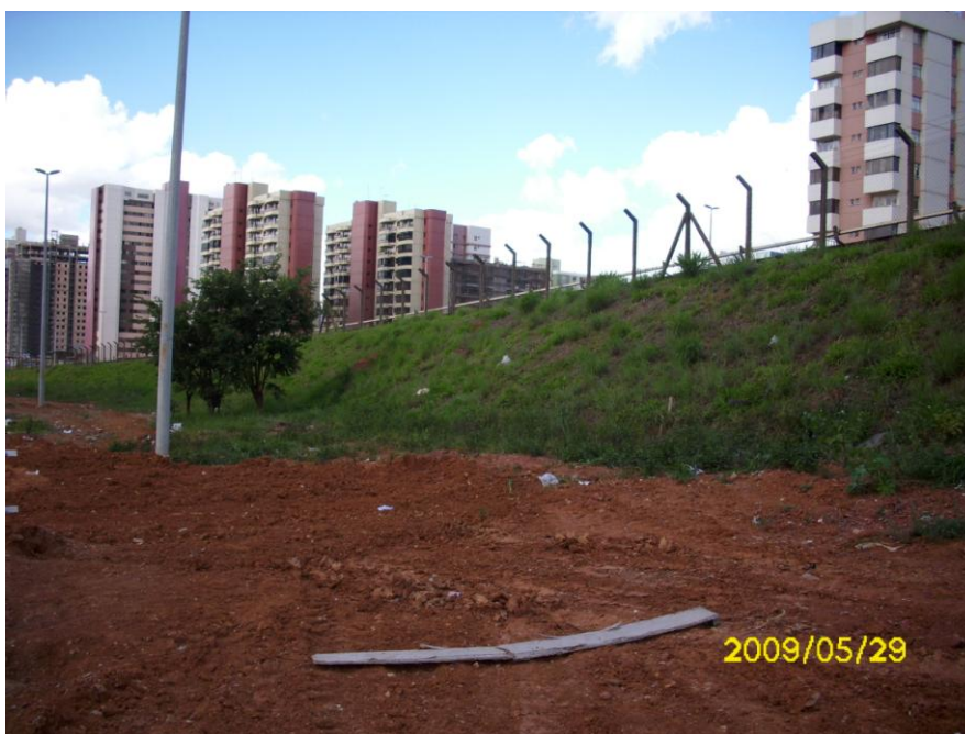
Foto 11: Área Pública localizada em frente à Edificação em Construção em Águas Claras que serve como área de empréstimo da obra da EMP B.
