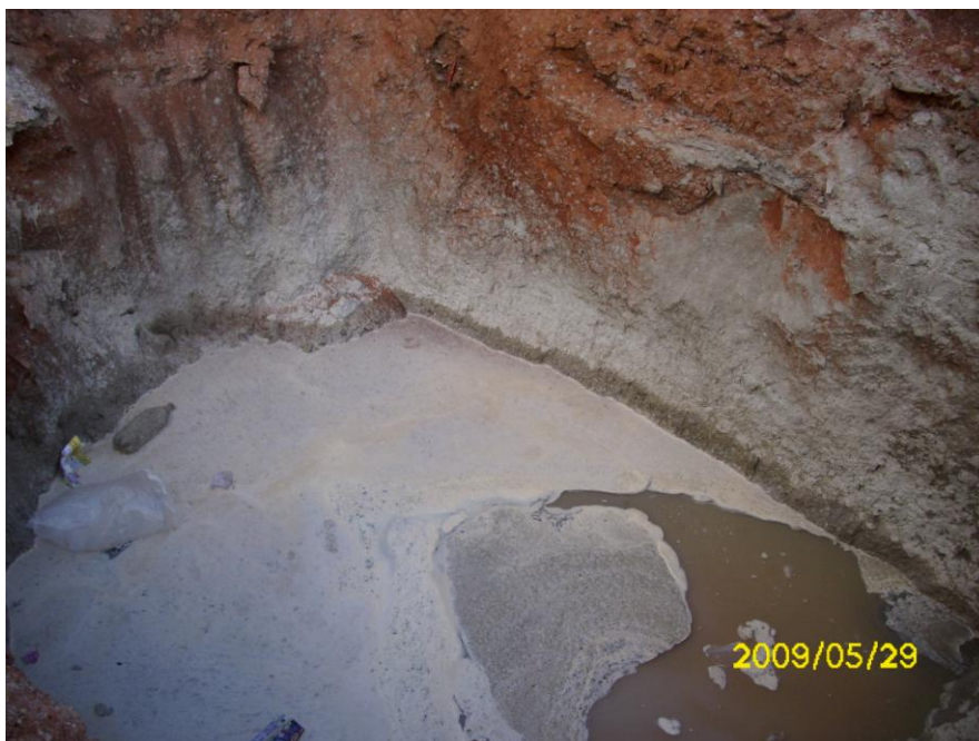
Foto 13: Tanque de limpeza construído em frente ao canteiro de obras em Águas Claras da EMP B e que serve para a lavagem das bicas dos caminhões de argamassa e concreto.
