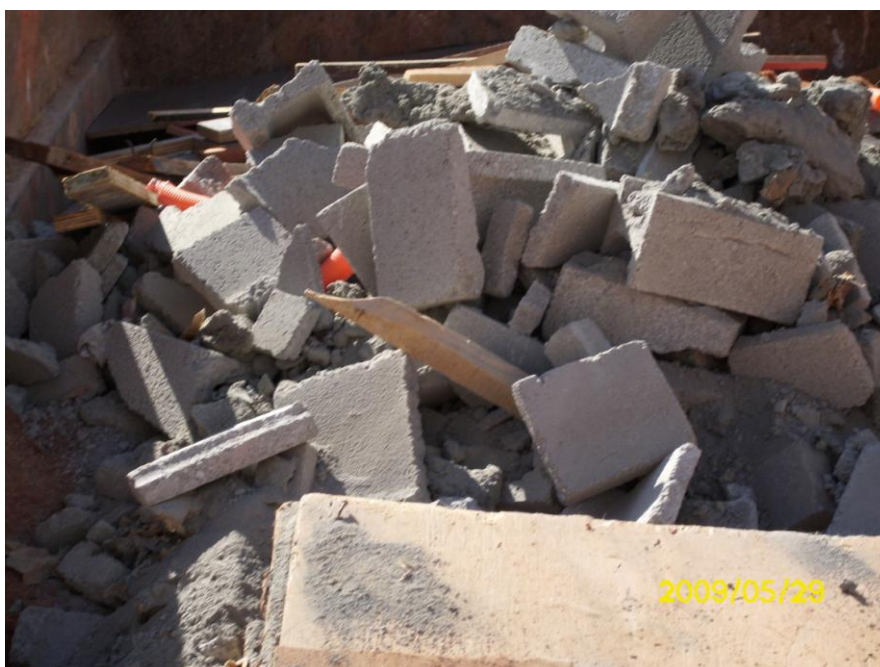
Foto 16: Depósito de Resíduos Classe A no canteiro de obras da EMP A.
