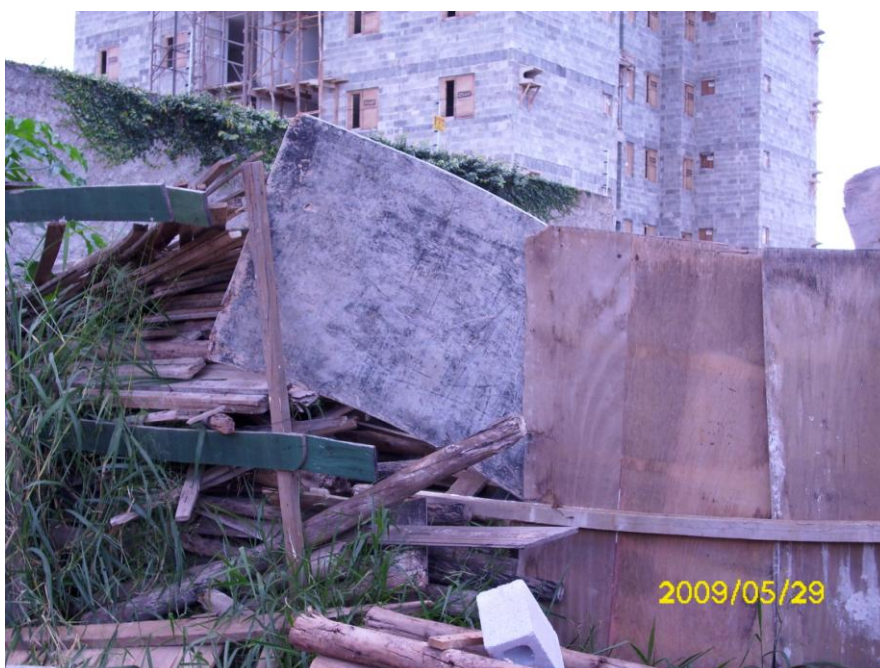
Foto 22: Terreno baldio alugado pela Empresa de Pequeno Porte B- EPP B para armazenamento dos Resíduos da Construção de Classe A e B gerados em suas obras localizadas em Águas Claras, aguardando coleta e transporte pela Empresa Coletora contratada.
