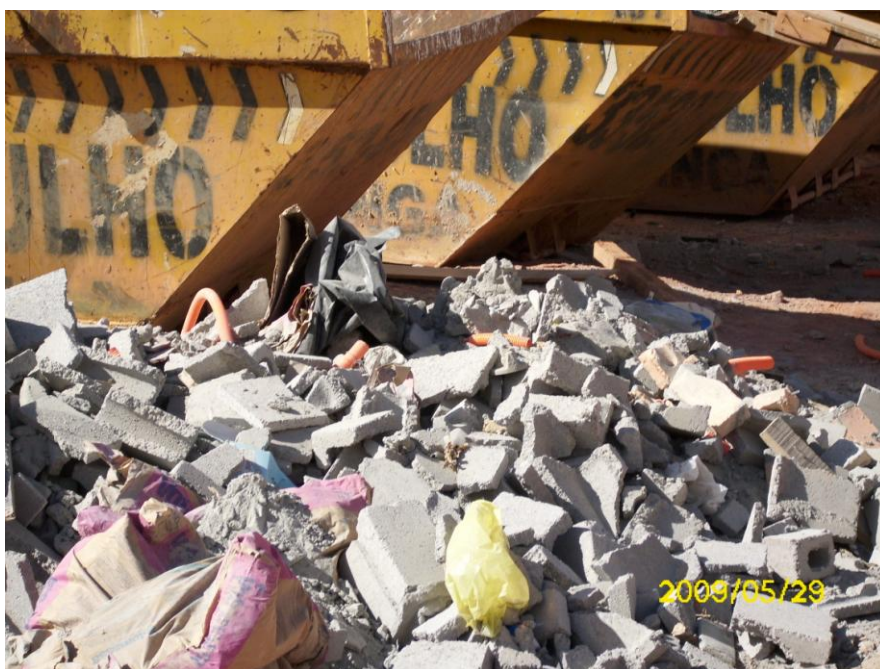
Foto 17: Resíduos de Classe A misturados com Lixo comum dispostos fora dos containers.
