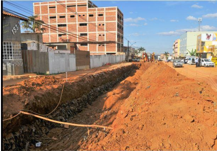
Figura 7: Recobrimento de vala após instalação do sistema de drenagem em trecho da Rua 12 de Vicente Pires, na altura do Cond. Jardins (Ch. 153/1).
