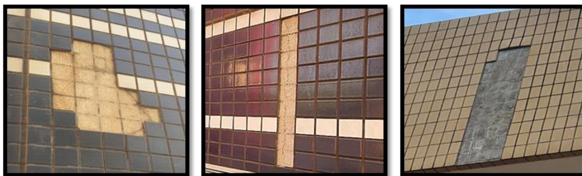
Figura 4 – Descolamento cerâmico em fachadas.
