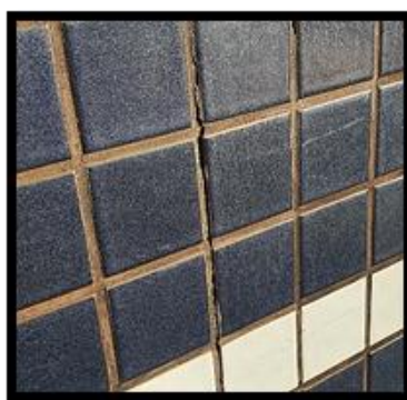
Figura 5 – Fissuras em sistema de revestimento cerâmico.
