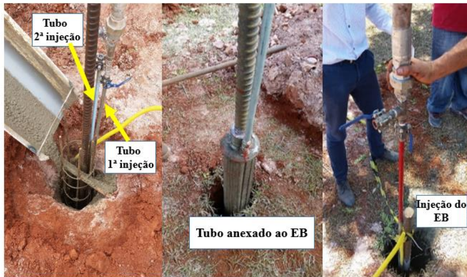
Figura 3.31. Processo executivo de estaca equipada com EB no Campo Experimental de Fundações da UnB (modificado – Silva et al. 2018).
