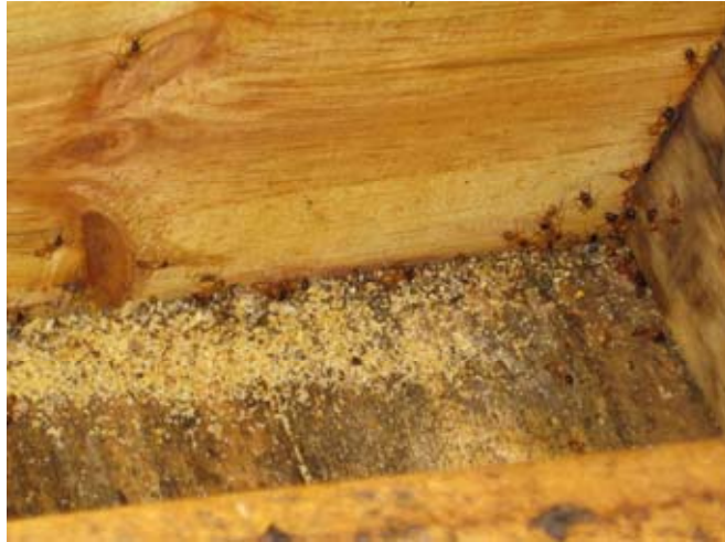
Figura 26 - Invasão de formigas em uma das caixas
