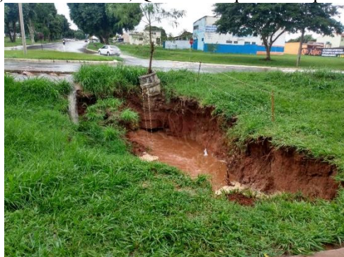
Figura 143 – Erosão, Q 10/11/Parque dos Jequitibás
