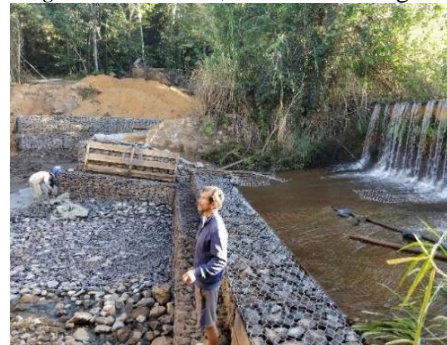
Figura 107 – Obra, erosão da barragem
