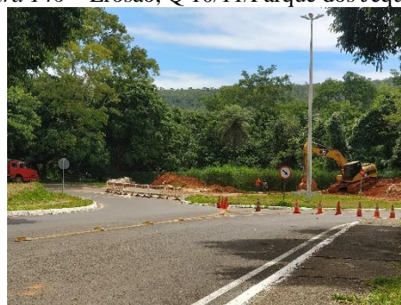
Figura 146 – Erosão, Q 10/11/Parque dos Jequitibás
