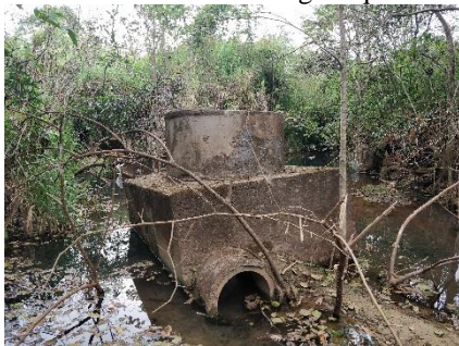
Figura 26 – Dano rede de drenagem quadras 13 e 15
