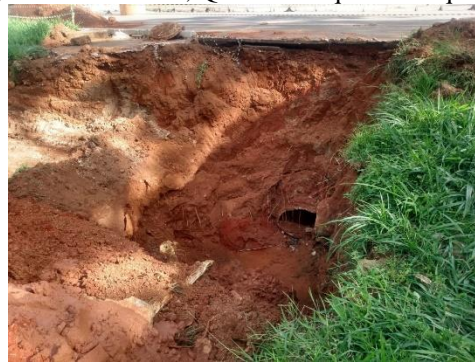
Figura 144 – Erosão, Q 10/11/Parque dos Jequitibás
