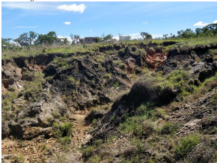
Figura 5 – Erosão na cabeceira do ribeirão Sobradinho
