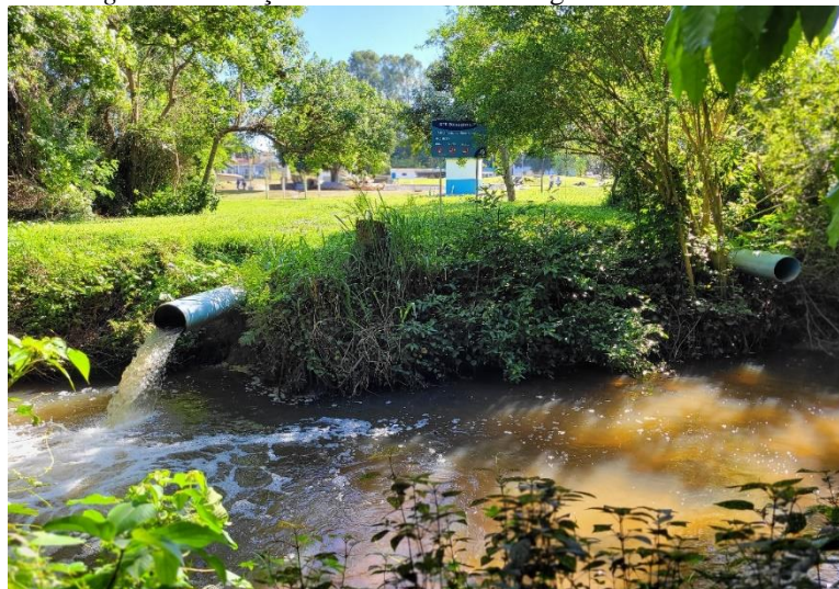
Figura 4 – Estação de Tratamento de Esgoto de Sobradinho
