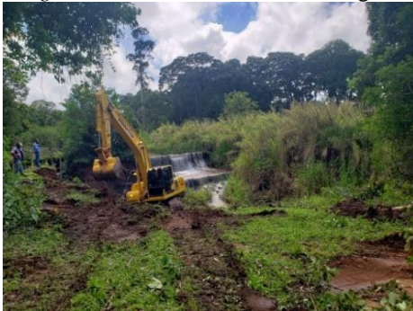
Figura 104 – Obra, erosão da barragem
