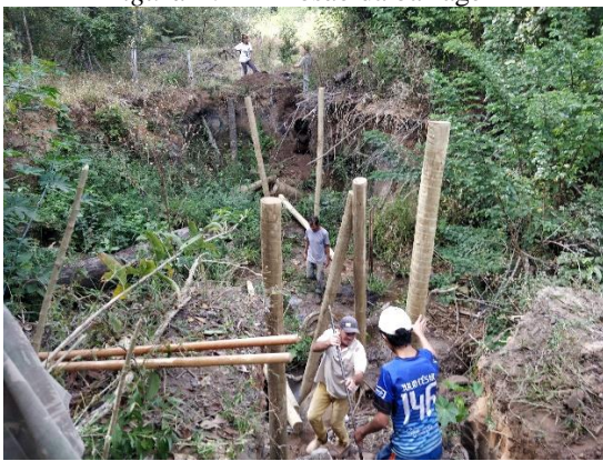
Figura 102 – Erosão da barragem
