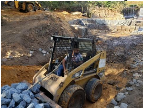
Figura 106 – Obra, erosão da barragem
