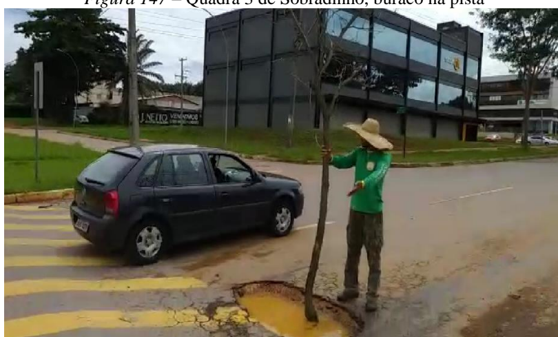
Figura 147 – Quadra 3 de Sobradinho, buraco na pista
