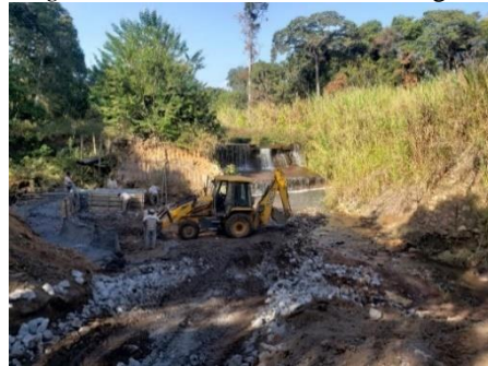
Figura 105 – Obra, erosão da barragem
