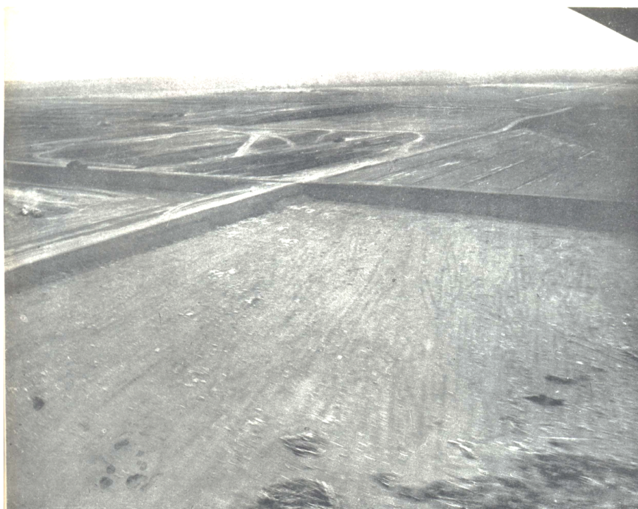
Figura 27: Cortes e aterros , construção de terraplenos na área central de Brasília (ca. 1958) Fonte: Arquivo Público do Distrito Federal – ArPDF.
