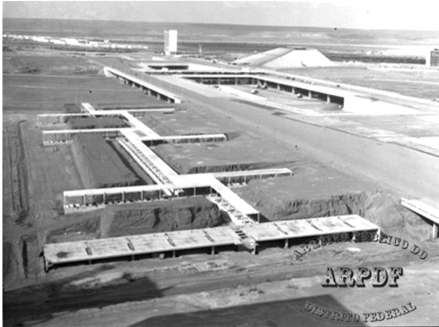
Figura 57: Fundação das áreas de circulação do conjunto , antes da retirada do aterro para criação do "falso" subsolo.
