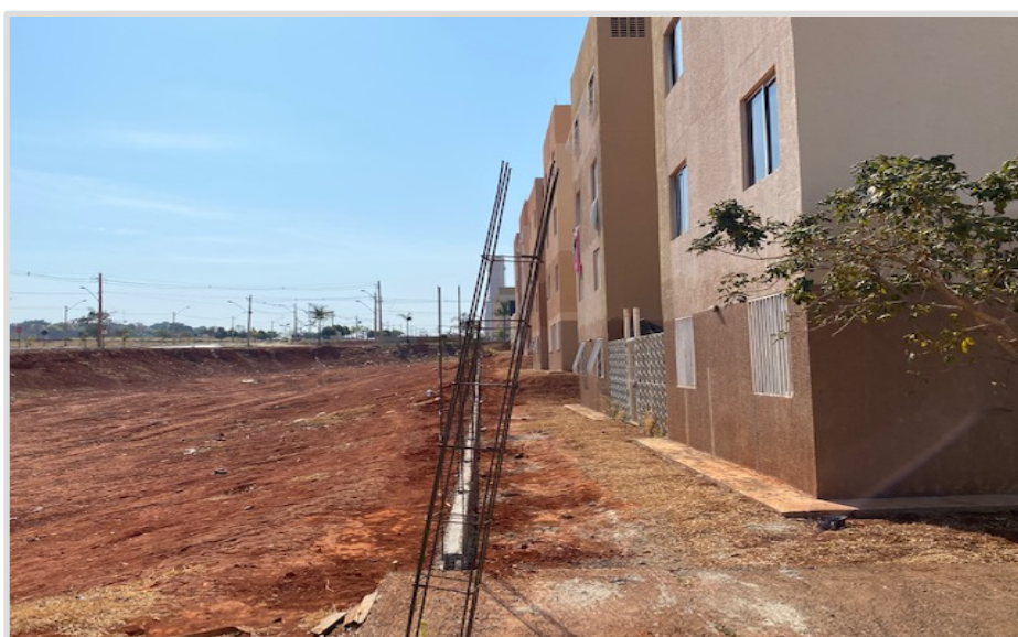
Fotografia 11: O solo exposto em acelerado processo erosivo. K.M. (2021)
