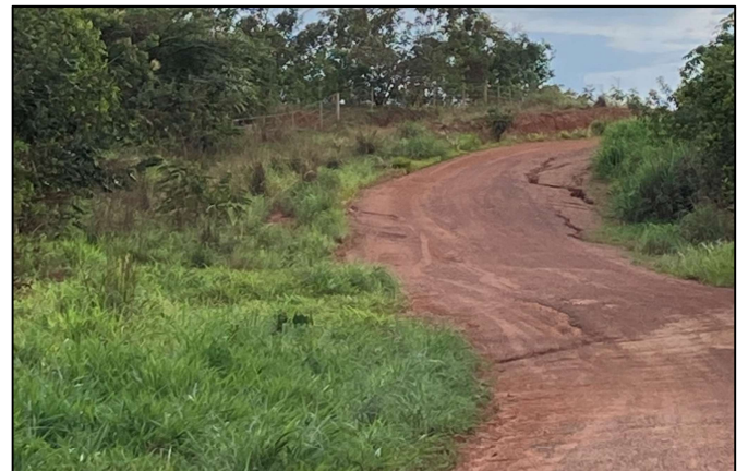
Figura C 27: Erosão em estrada próximo ao Ponto 1.
