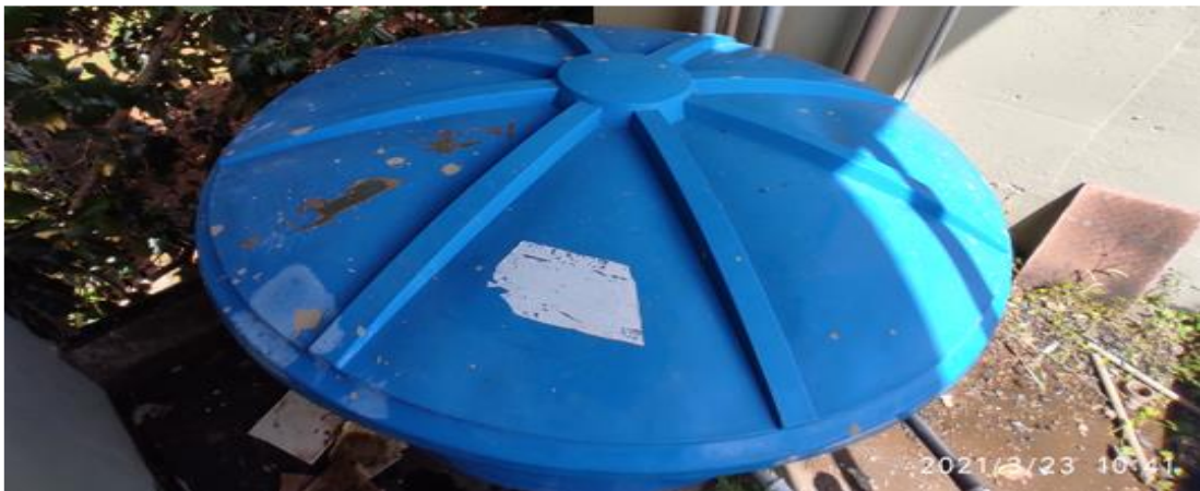
Figura 32: Caixa d'água em fibra de vidro (FNDE/UNB, 2021)
