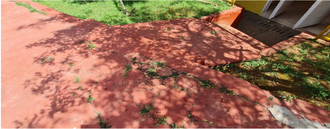
Figura 49:Revestimento de piso área externa com rachaduras (FNDE/UNB, 2021)
