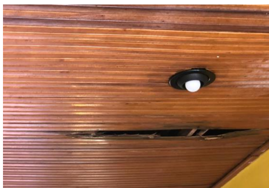
Figura 28:Forro danificado (FNDE/UNB, 2021)
