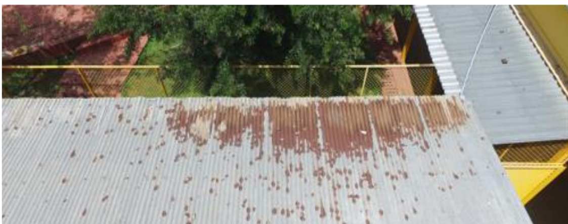
Figura 30: Estado de degradação -Telhas (FNDE, 2021)
