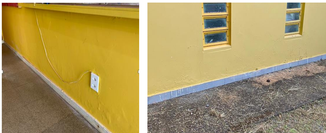
Figura 46: Alvenarias com sinais de percolação (FNDE, 2021)
