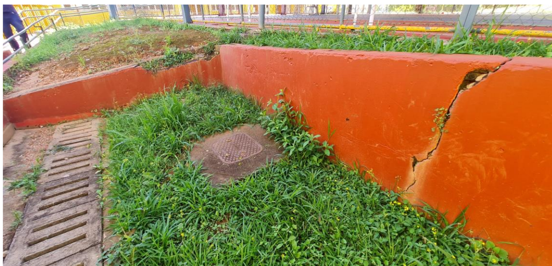
Figura 36: Degradação de alvenaria devido a problemas de drenagem. (FNDE/UNB, 2021)
