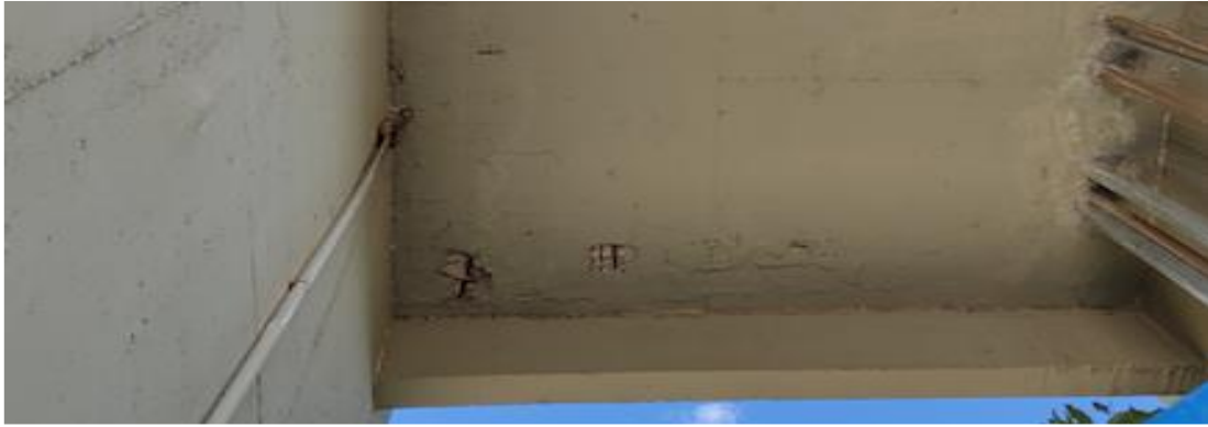
Figura 31: Infiltração na laje de fundo do reservatório (FNDE/UNB, 2021)
