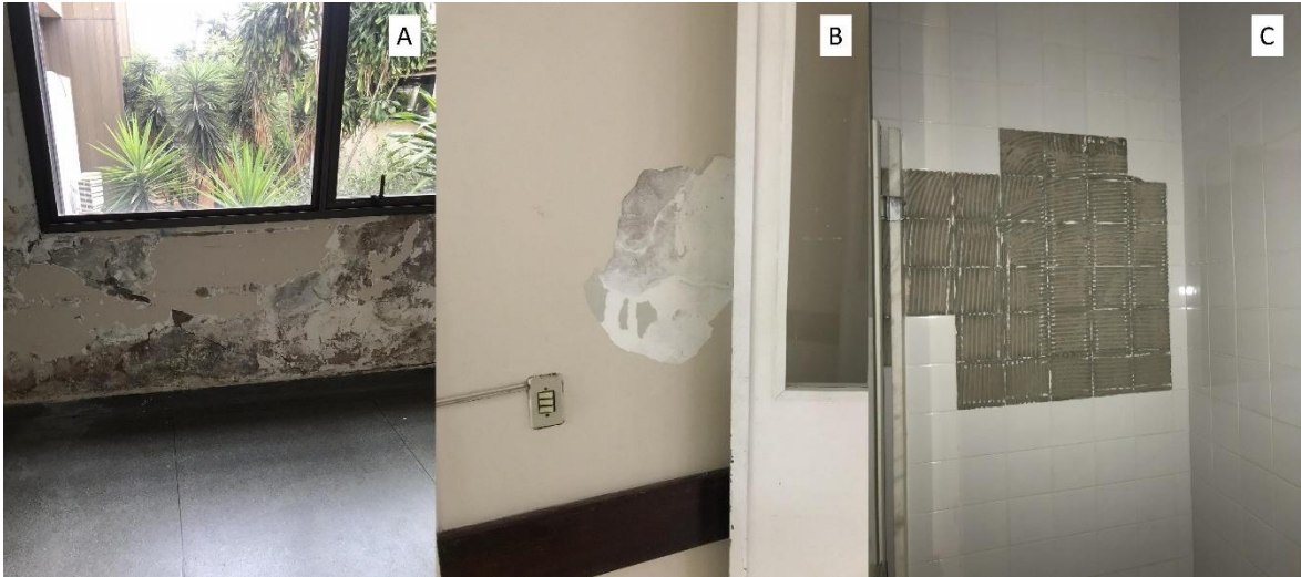
Imagem 60 – Estado de conservação paredes e bate maca Autor: Alyria Argôlo Donegá. Data da foto: 22/09/2019.
