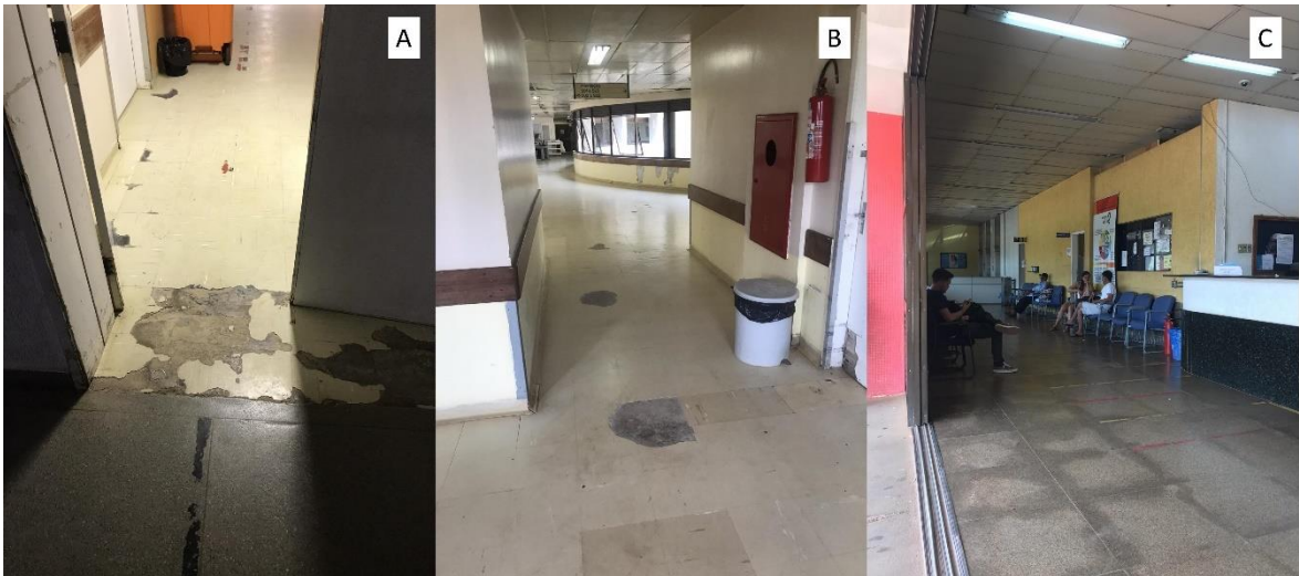
Imagem 61 – Estado de conservação piso Autor: Alyria Argôlo Donegá. Data da foto: 22/09/2019.
