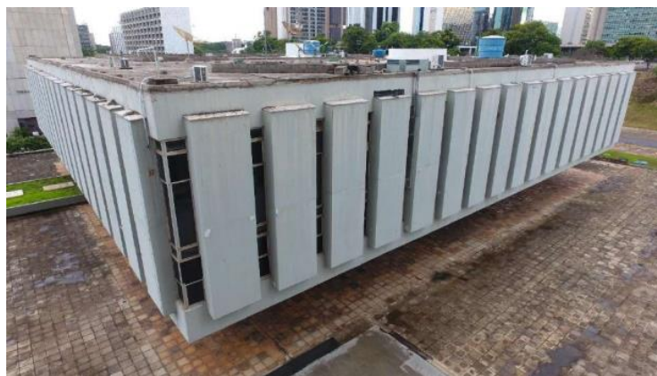
Figura 4-23 - Imagem do Relatório de Drone - Fachada Norte (vértice posterior).
