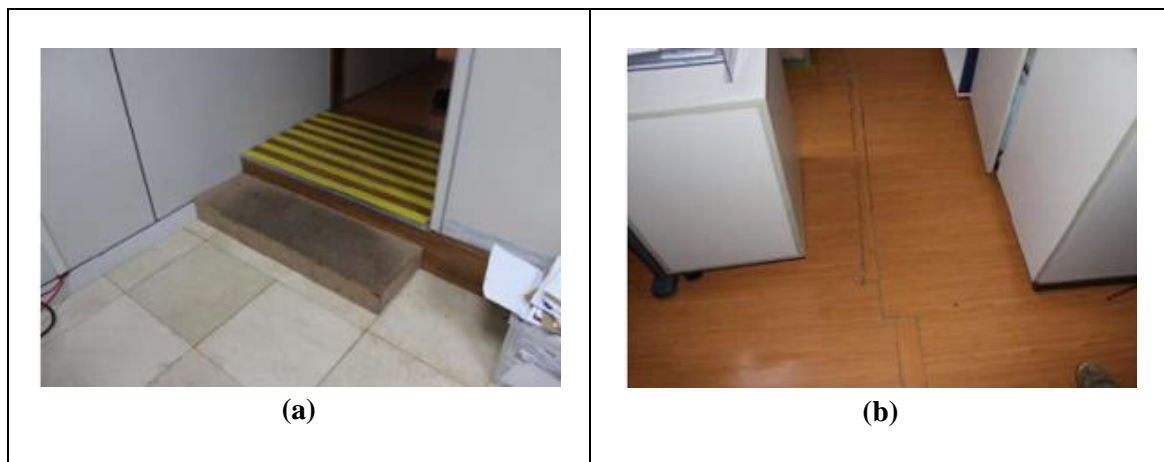
Figura 5-23 - (a) Desnível de piso e descontinuidade de materiais de acabamento; (b) Piso vinílico com marcas de divisórias devido às adaptações de layout.
