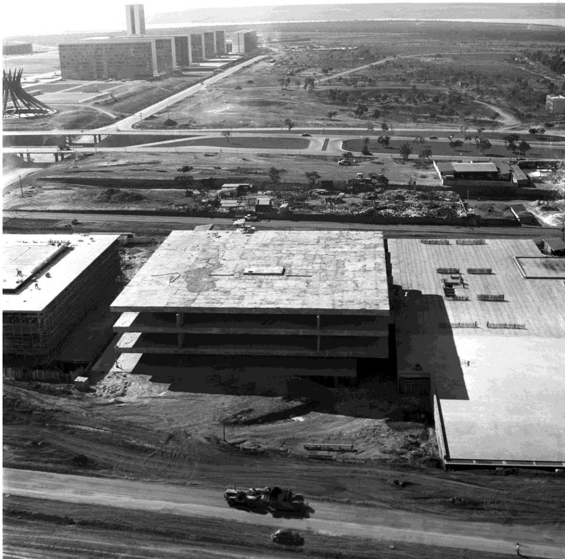
Figura 5-12 - Construção do Edifício Anexo I. Na foto é possível ver a esplanada dos ministérios e a construção das vias da capital (1968).
