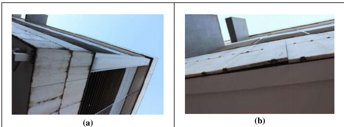
Figura 5-21 - (a) Falta de limpeza das rochas; (b) Deslocamento das rochas; (c) Chapim sem manutenção; (d) Abertura nas esquadrias com infiltrações.
