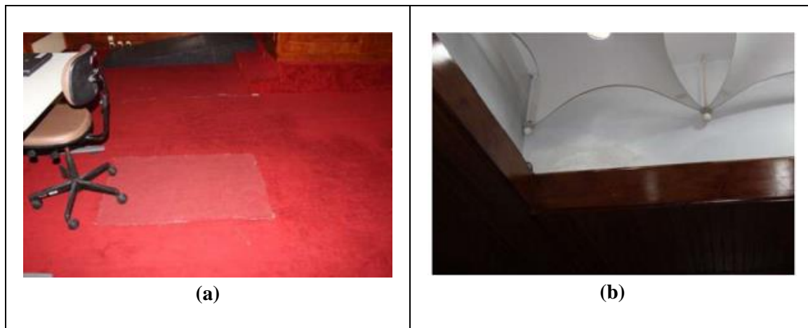
Figura 5-25 - (a) Remendo em carpete; (b) Infiltração em forro do plenário.
