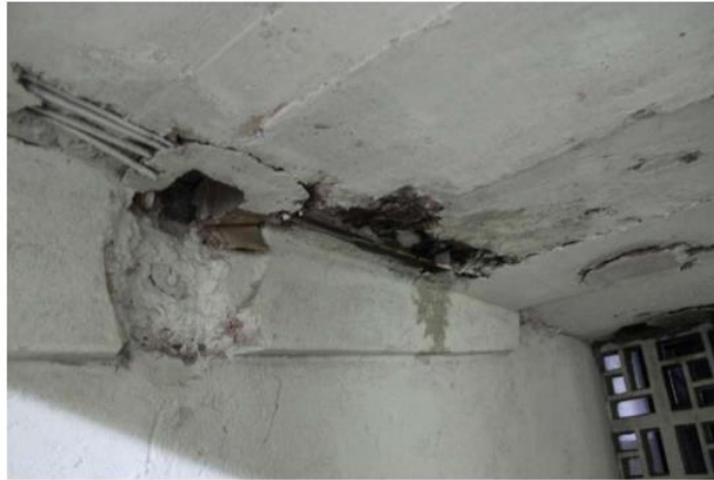
Figura 4-22 - Patologia em armadura oxidada de concreto armado do Ed. Sede I.
