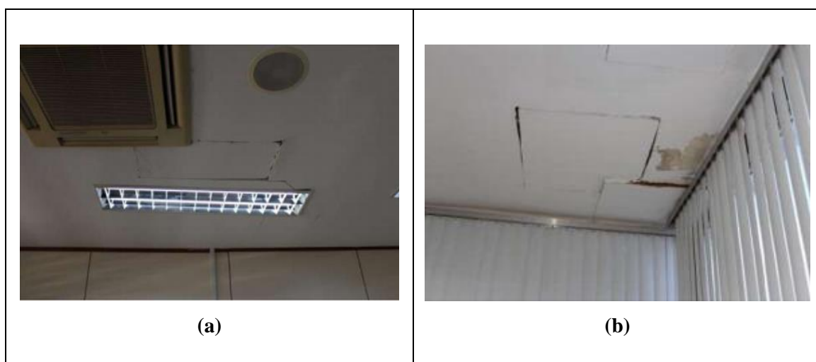
Figura 5-24 - (a) Recorte no forro de gesso para movimentação e manutenção das máquinas de ar-condicionado e luminárias; (b) Recorte no forro e pontos de infiltrações.
