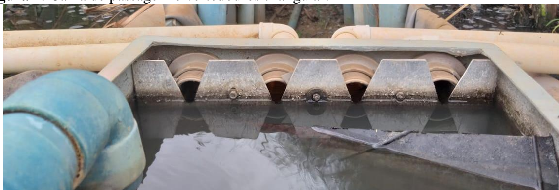
Figura 2. Caixa de passagem e vertedouros triangular.
