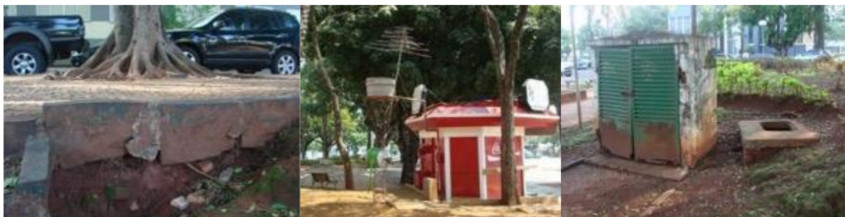
Figura 121: Pontos de degradação notados na Praça Cívica antes da requalificação. Fonte: Domínio Público
