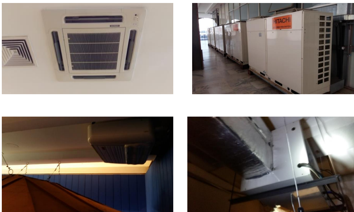
Figura 72: Sistema de ar condicionado do Palácio do Itamaraty.
