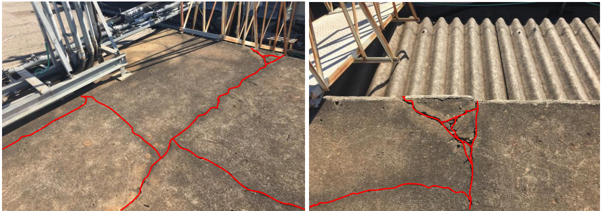
Figura 47 e Figura 48 – Fissuração e desagregação na proteção mecânica (Autor, 2019).
