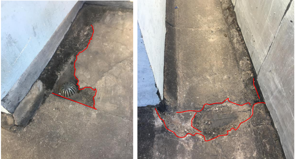
Figura 51 e Figura 52 – Desagregação do concreto e fissurações na proteção mecânica (Autor, 2019).
