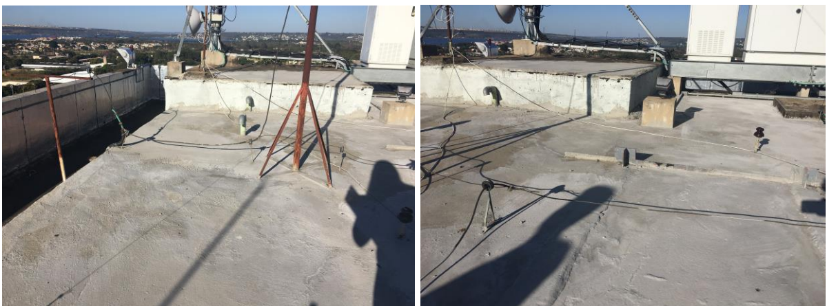
Figura 49 e Figura 50 - Aplicação de uma Argamassa Polimérica Cinza para a impermeabilização das infiltrações (Autor, 2019).
