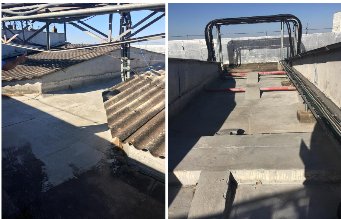
Figura 45 e Figura 46 – Aplicação da Argamassa Polimérica Cinza para a impermeabilização das infiltrações (Autor, 2019).
