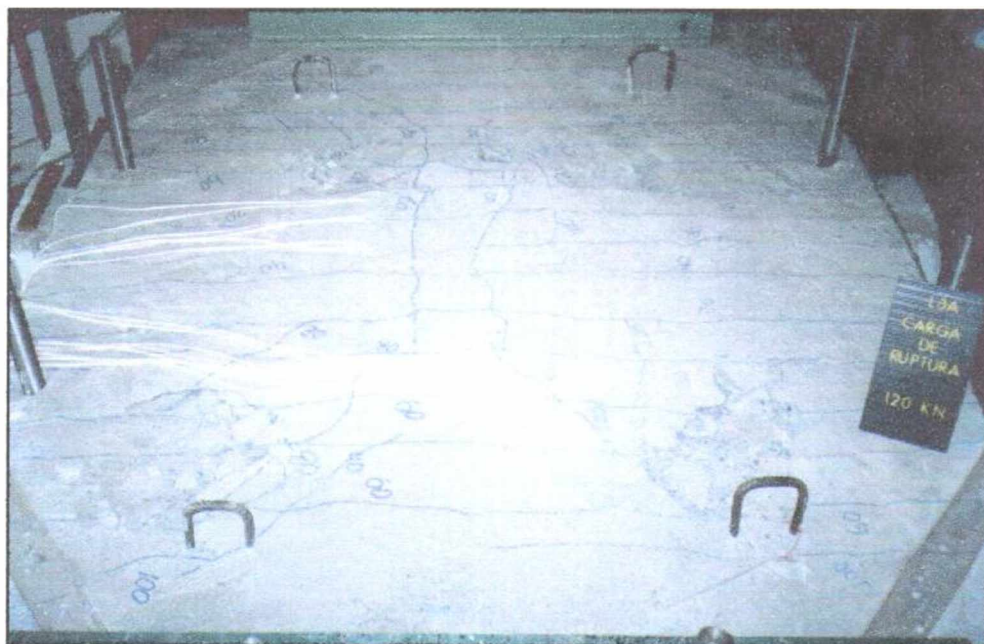
Figura 4.12 – Mapa de fissuração da laje L3a
