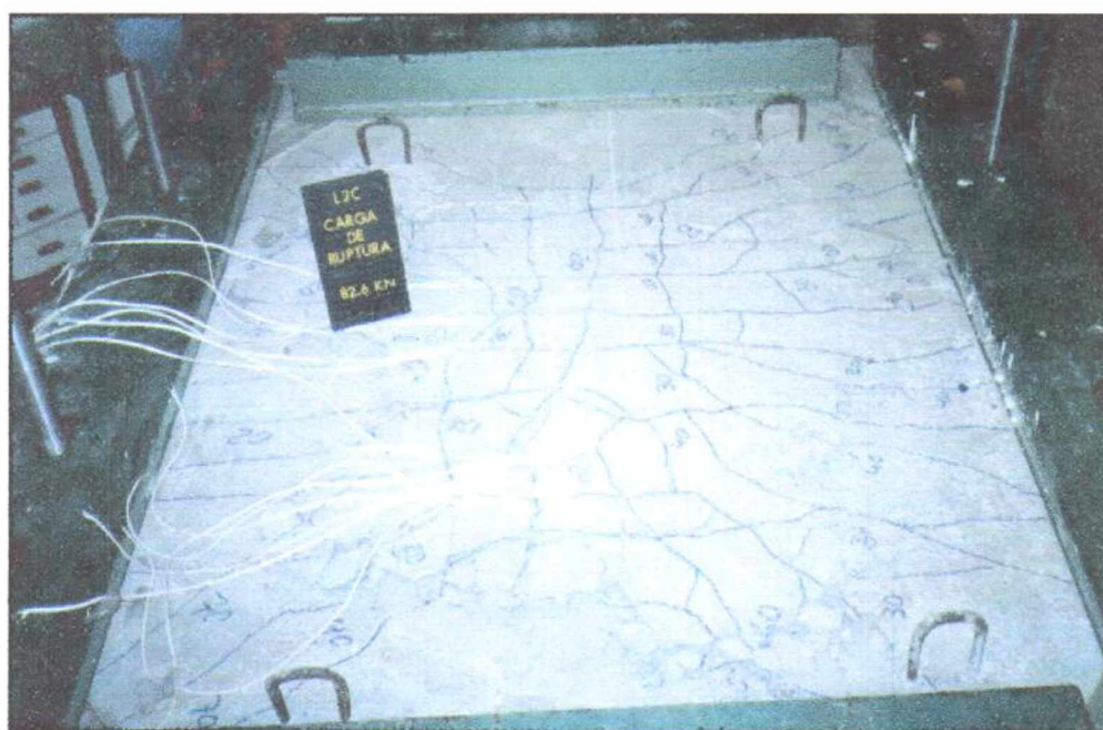
Figura 4.11 – Mapa de fissuração da laje L2c
