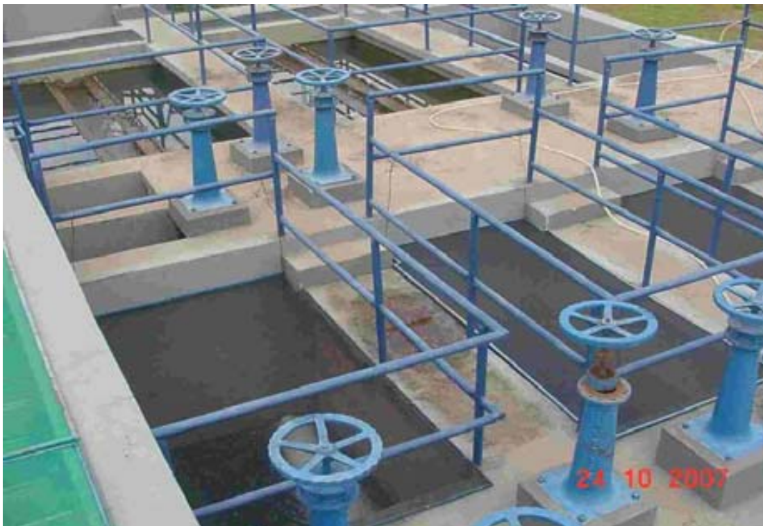
Foto 5 – Sistema de floculação e cloração. (foto: Vonivaldo G. Leão)
