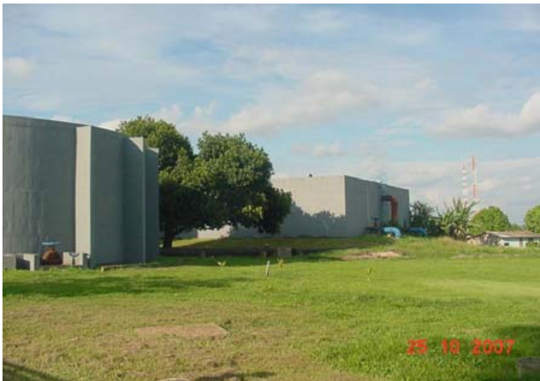
Foto 15 – Reservatório de água tratada. (foto: Vonivaldo G. Leão)
