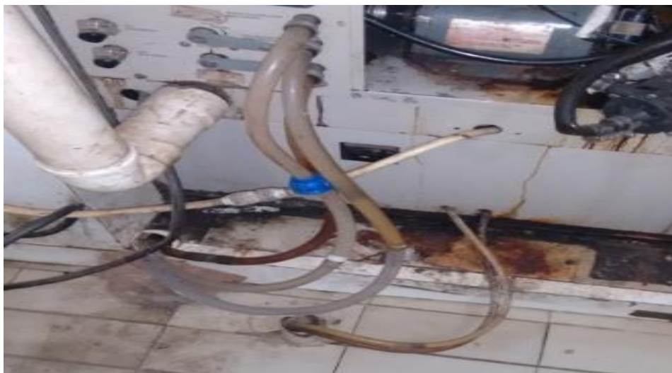
Figura 15: Descarte de efluentes diretamente no esgoto Fonte: Autor da pesquisa
