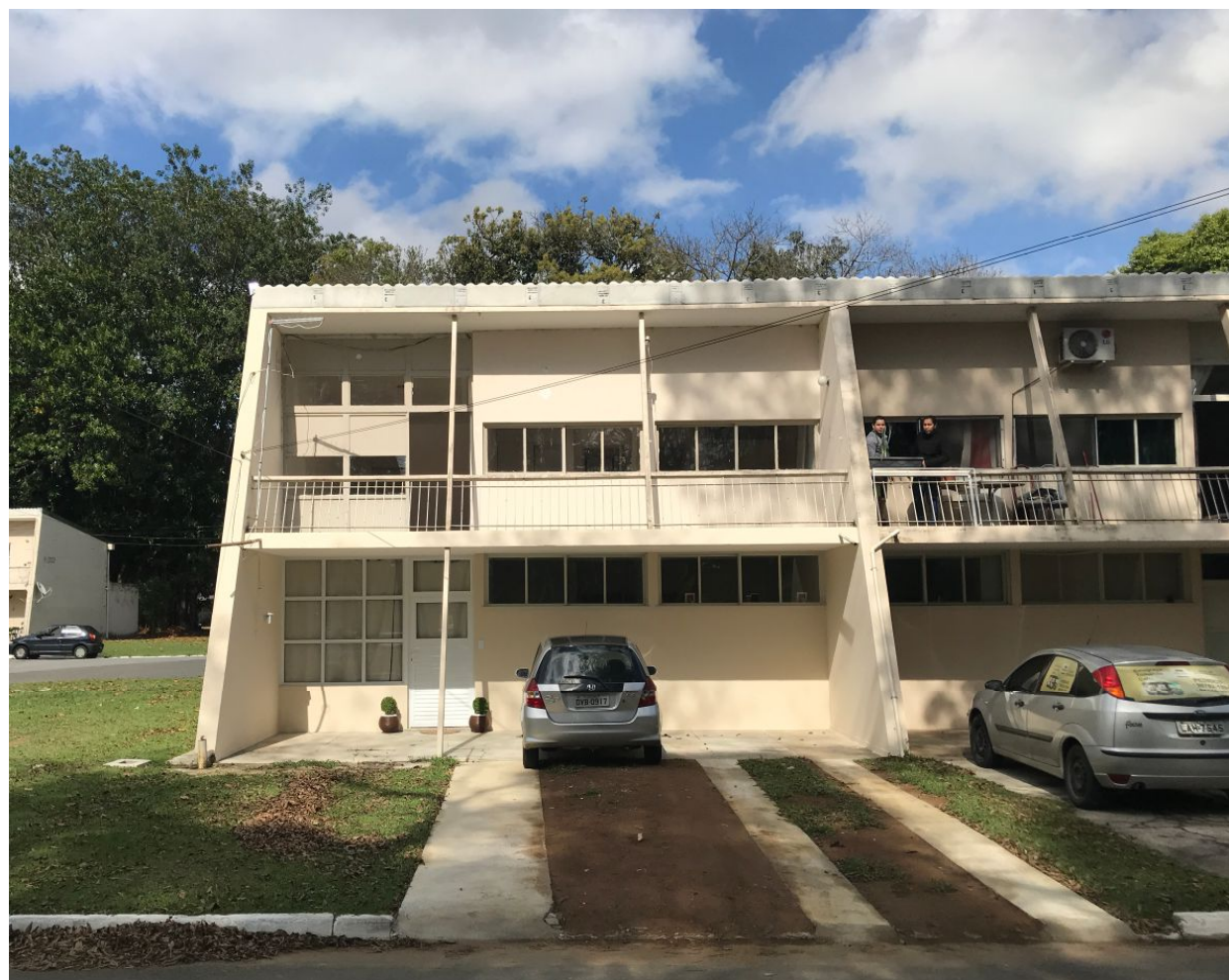
Figura 51 - Fachada de uma unidade do H-18 em 2018 e a síntese de modificações em outras unidades. Gelosias retiradas, jardim usado como garagem, guarda-corpo metálico e coroamento com arremate em fibrocimento ondulado. Fonte: Autor, 2018.
