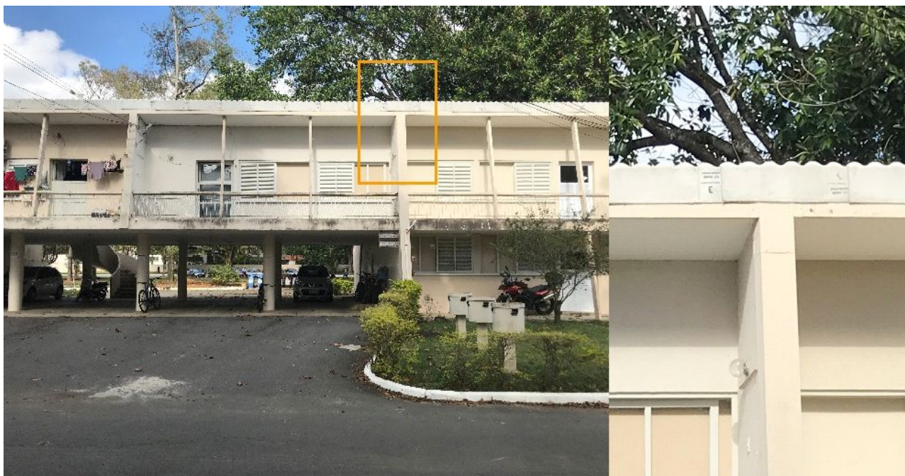
Figura 39 - Fachada Frontal em 2018. Sem as gelsias e com os detalhes do coroamento em fibrocimento. Fonte: Autor, 2018.
