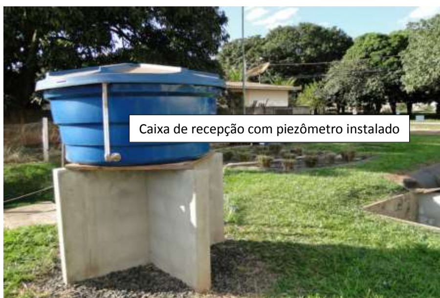
Figura 4.15 – Caixa de recepção do esgoto e piezômetro instalado para medição do nível de esgoto dentro da caixa.
