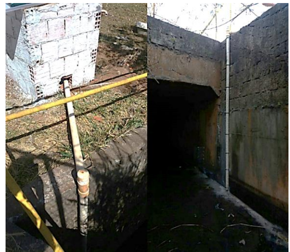
Figura 4.16 – Tubulação de conexão entre o amostrador e a galeria de águas pluviais.
