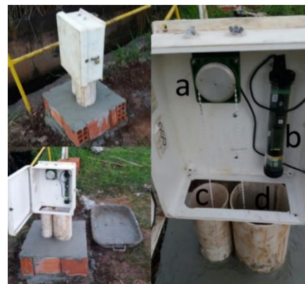
Figura 4.13 – Linígrafo instalado, em que: (a) Contador de variação de nível ; (b) Data logger ; (c) Tubulação para o contrapeso ; (d) Tubulação com comunicação com o canal, onde a boia está alocada .
