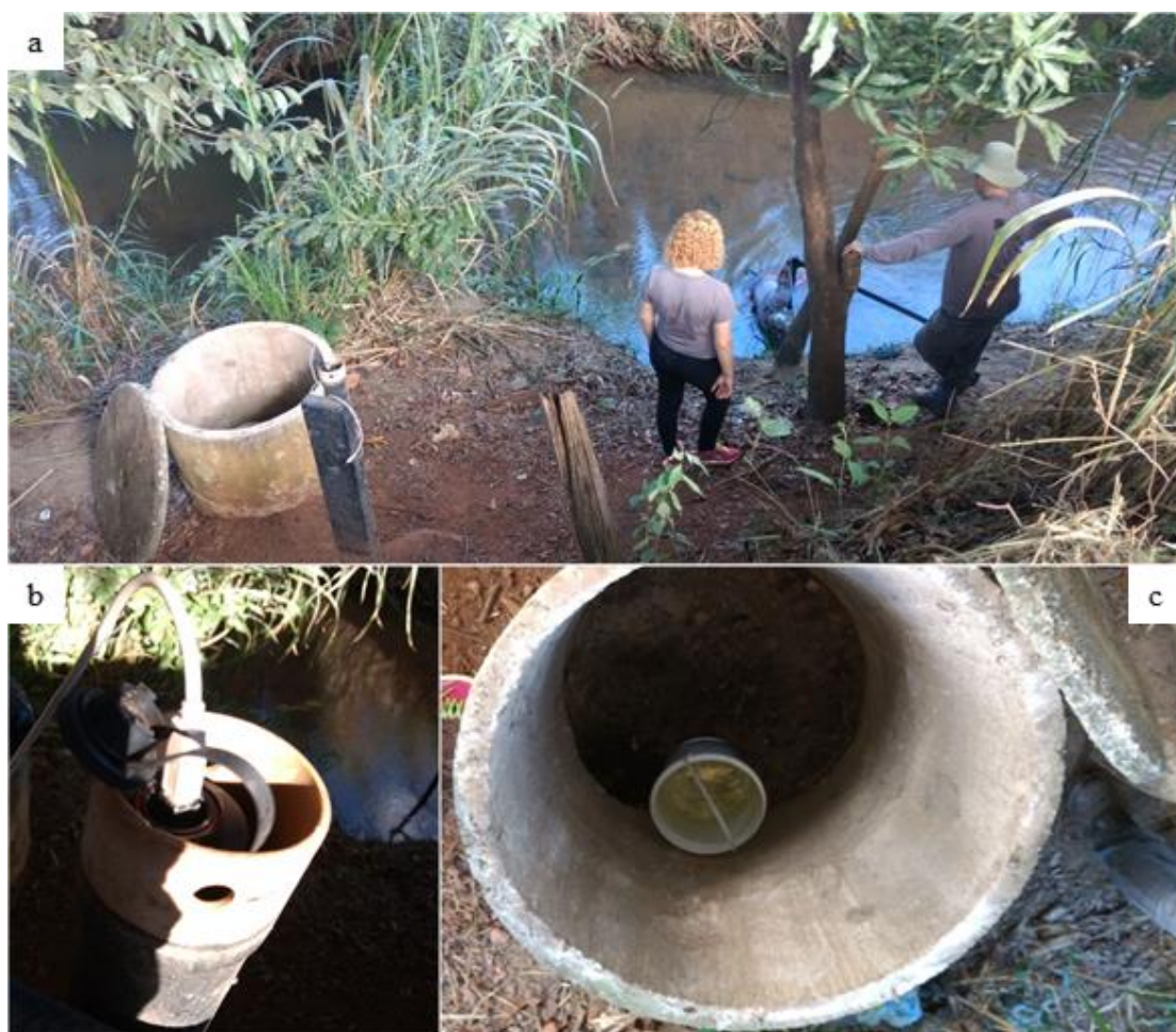
Figura 4.18 - Registros fotográficos do monitoramento. (a) Estruturas da estação monitoramento da CAESB. (b) Linígrafo com data logger . (c) Manilha aberta. (Fonte: arquivo pessoal).
