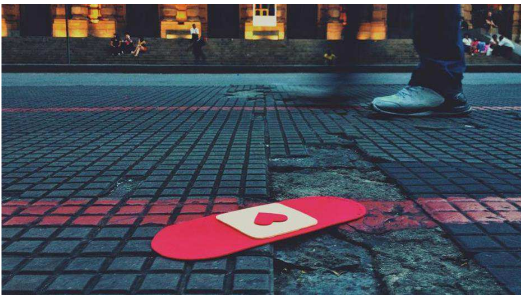
Figura 43 - Calçada danificada e assistida pelo projeto Curativos Urbanos. Fonte: São Paulo, 2015.
