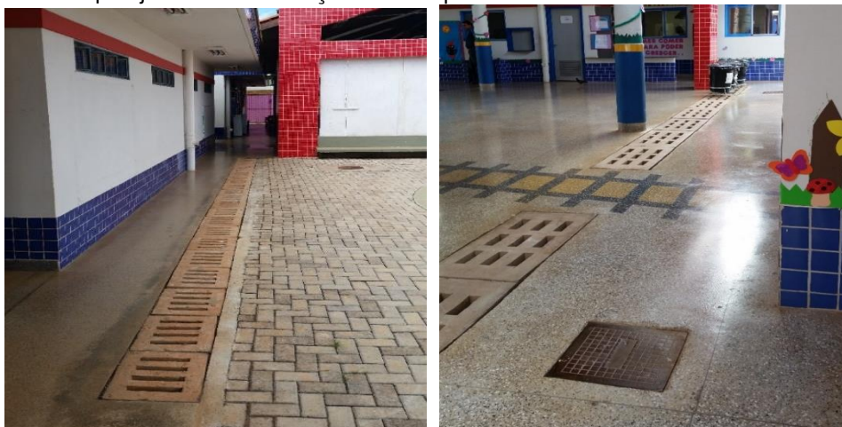
Figura 174: Calha de piso no corredor mais extenso da escola – CEPI Capim Dourado. Figura 175: Calha de piso junto à administração - CEPI Jequitibá.
