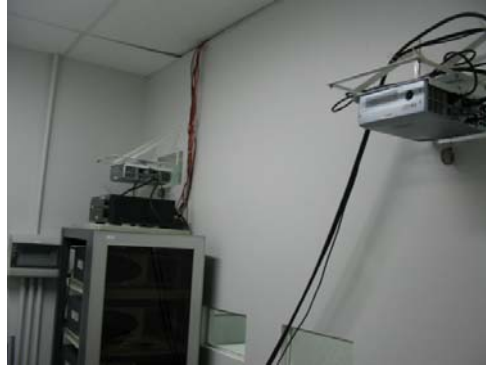
Figura - - Detalhe dos projetores que ficam na Sala de Controle
