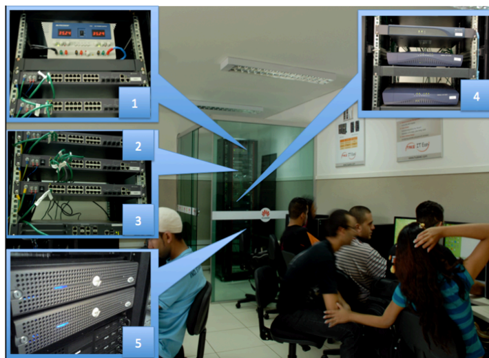
Figura 4.1 - Laboratório de Redes: 1) fonte de energia estabilizada, 2) switches, 3) firewalls, 4) roteadores, e 5) servidores para a instalação de serviços de redes.
