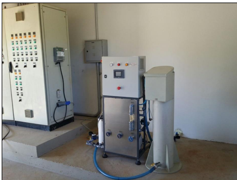
Figura 4.5 – Planta-piloto FMS PTARH-UnB-RENTED/CAESB instalada no interior da Casa de Química da ETE Gama. Detalhe do Medidor de energia elétrico instalado na lateral do console do quadro elétrico já existente.
