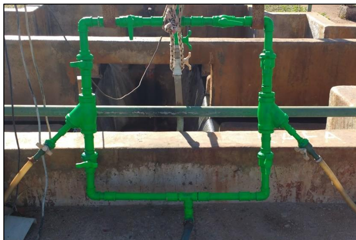
Figura 4.8 – Fotografia do local do poço de bombeamento da rede de recalque da Planta-piloto FMS – PTARH/UnB/RENTED/CAESB e da instalação do pré-tratamento (peneiramento fino). Caixa de passagem do efluente do reator anaeróbio A e B da ETE Gama.
