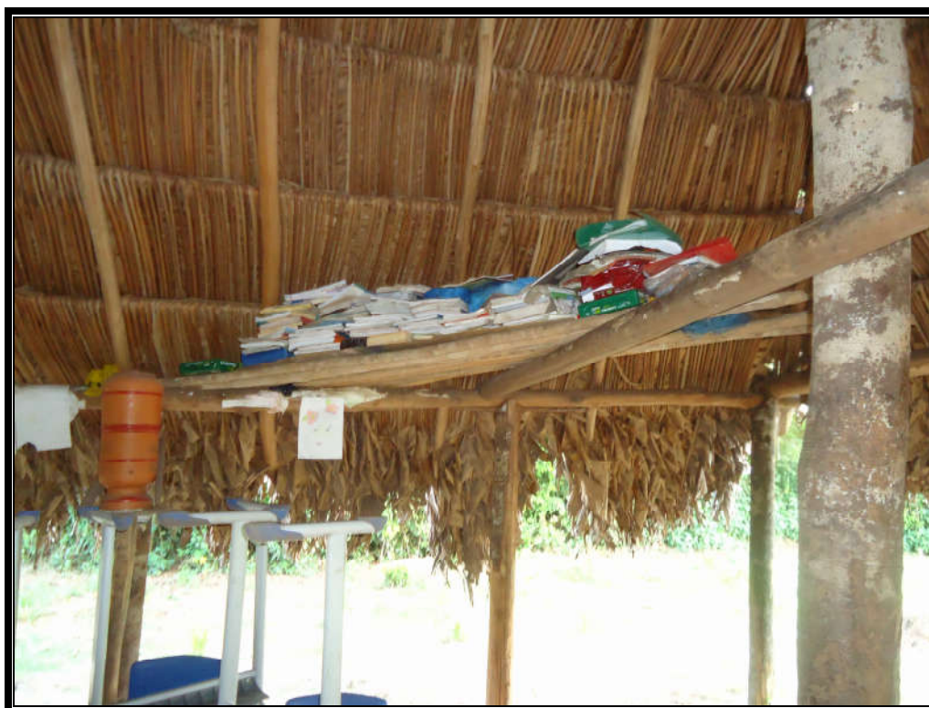
Imagem 02: Material didático guardado em prateleiras improvisadas dentro da estrutura da Escola Goronã. Especialmente os papéis sofrem com a alta umidade do local, já que estão no alto da construção, próximos ao teto de palha. Há desenhos dos alunos mais novos, como os da imagem, pendurados em toda a estrutura da Escola Goronã.
