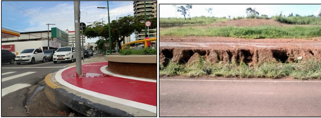
Figuras 2.8 e 2.9: Exemplos de ciclovias não sustentáveis respectivamente em Manaus (poste) e em Brasília (talude erodido) (GLOBO, 2015 e ASSOCIAÇÃO PARK WAY RESIDENCIAL, 2015)
