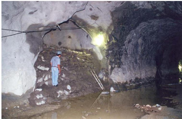
Figura 2.10 – Colapso da parede lateral (Seidenfuss, 2006).
