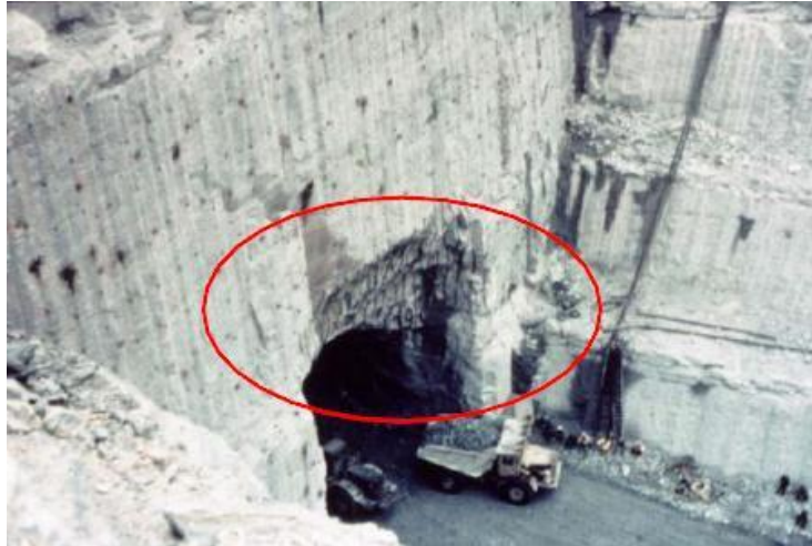
Figura 2.13– Colapso do teto no portal da escavação (Seidenfuss, 2006).
