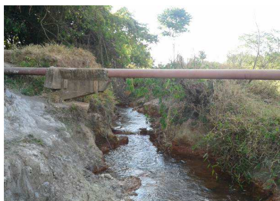
Figura 13. PJ3, detalhe da adutora de água da SANEAGO, próximo ao Residencial Califórnia, ocupação urbana recente cerca de 120 metros do ponto.
