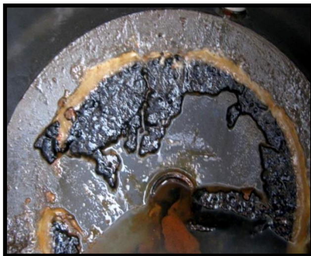
Figura 1: Aparência de um fundo de tanque de armazenamento com resíduo de contaminação.
