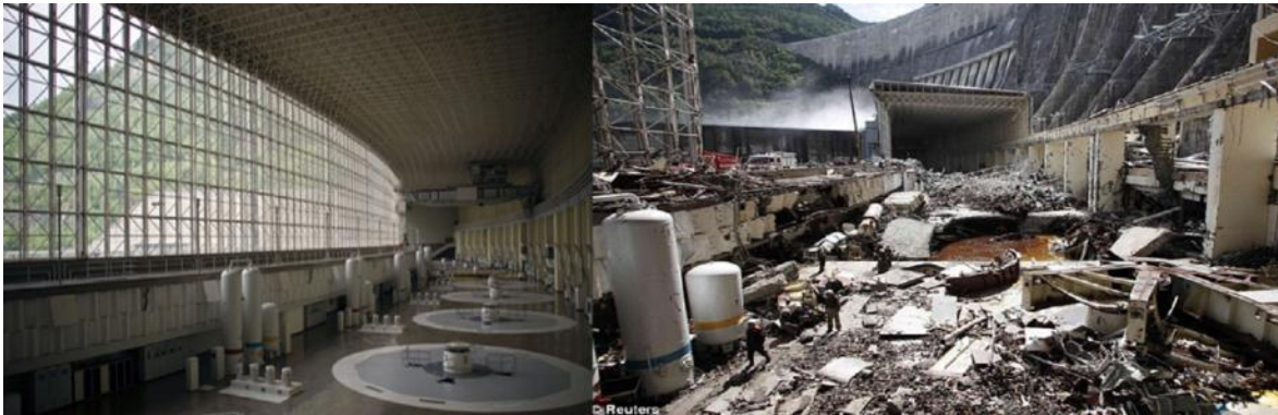
Figura 2.7 – Casa de máquinas antes e depois do acidente (Fonte: Cruz, 2009).
