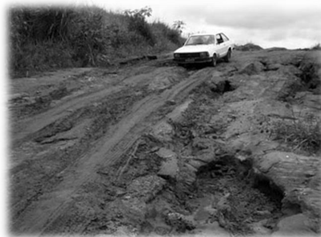
Figura 2.3 Afundamento de trilhas de roda numa estrada.
