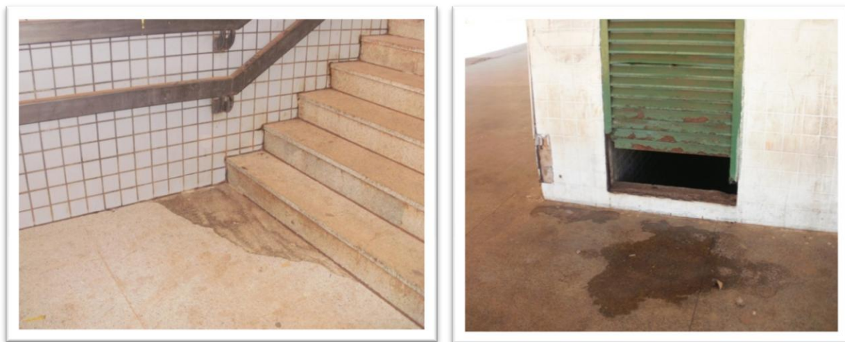
Figura 27 – ‘Sanitários’ improvisados nas escadas internas e na marquise sob o ponto de ônibus do Eixo W (ferrugem corroendo a grade de ventilação e inspeção). Foto: Gabriel Melo
