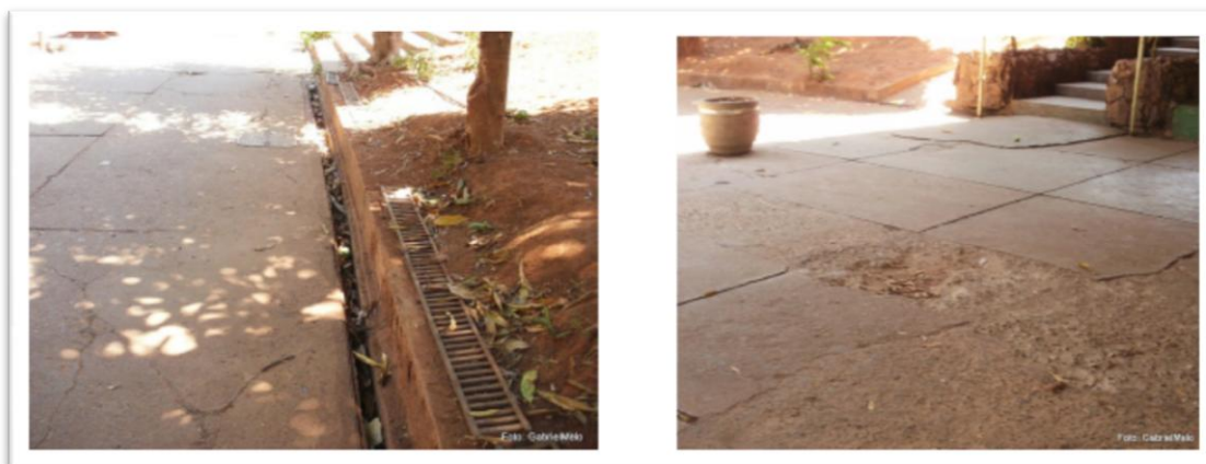
Figura 23 – Grelhas expostas e calçadas quebradas na área Central sob o Eixão. Fotos Gabriel Melo.
