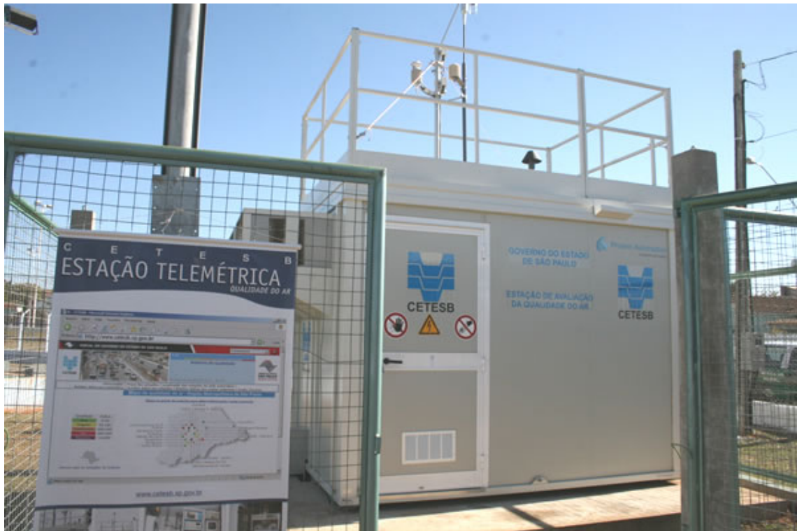
Figura 2. Estação fixa de monitoramento da qualidade do ar. Fonte: CETESB (2013).
