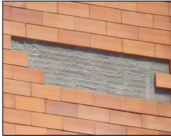
Figura 1.1 Deslocamento de Revestimento Cerâmico( https://www.google.com.br/fachadas+de+casa )
