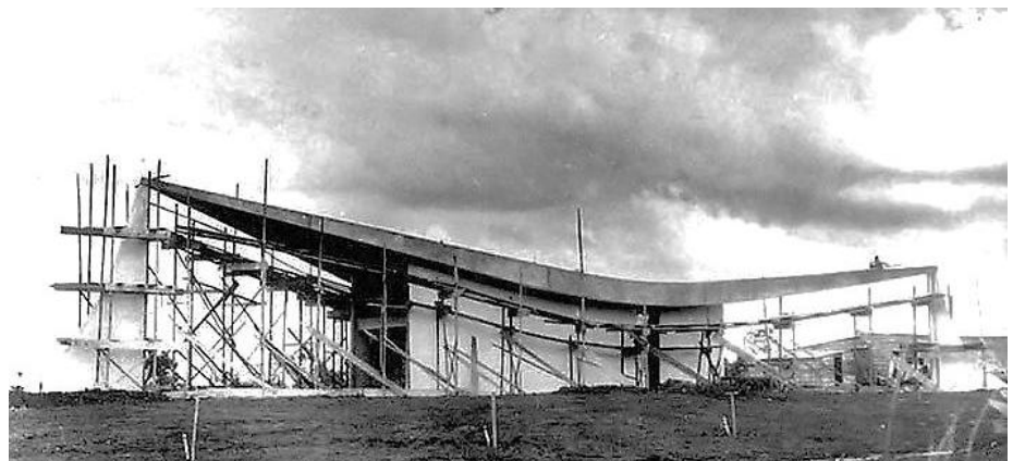
Figura 105 | Escoramento da cobertura. H. Franceschi. Sem data Levantamento Fotográfico. DAU/NOVACAP. Arquivo Público do Distrito Federal
