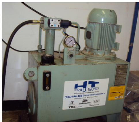
Figura 3.16 Conjunto motor Bomba.
